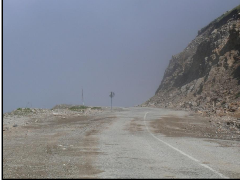
Fotoğraf 8. Geçit çevresinde yol standartlarında bozulmalar görülebilmektedir.
