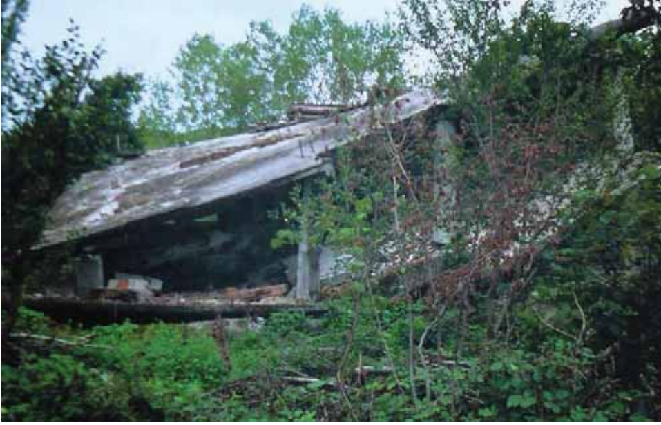
Foto 6. Topağaç köyü Tepecik mahallesinde (Ayancık) heyelan nedeniyle yıkılan betonarme konut
